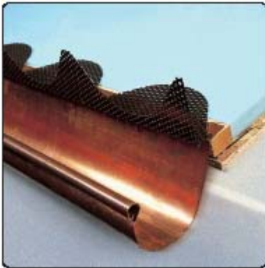
Fase 1: posa della griglia parapassero sul canale di gronda avendo cura di posizionarla circa 2 cm a sbalzo su di essa per permettere la percolazione dell'acqua.
