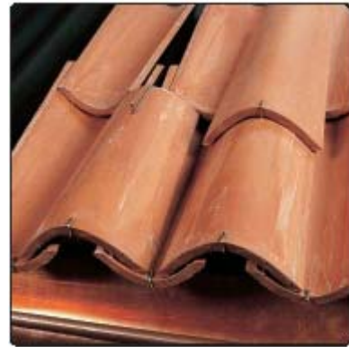
Fase 5: continuare la copertura del tetto inserendo i ganci per coppi su tutte le file (circa 15 al mq).
